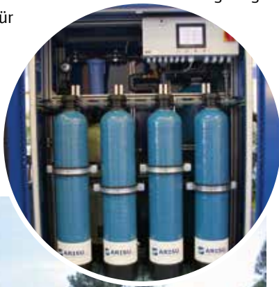
Die technische Anlage von ARISU GmbH
